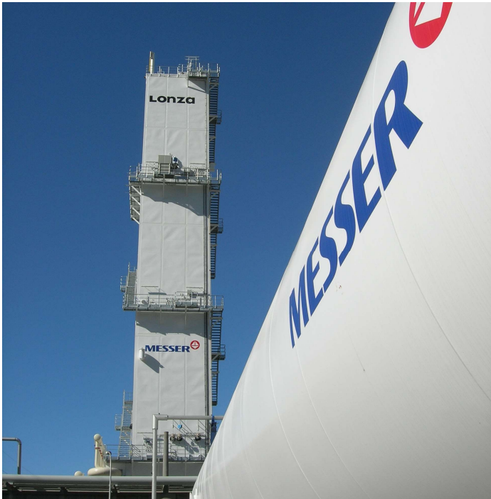
Luftzerlegungsanlage (Stickstoff, Sauerstoff, Argon) Visp / Lalden
